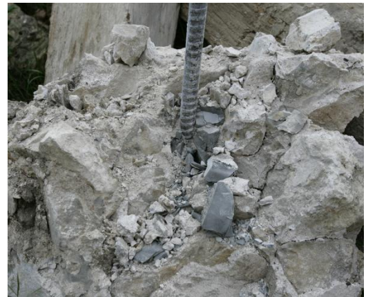
Völlig zerstörtes Gefüge im Kirchturm von Eilenstedt. infolge fehlerhafter Materialauswahl (Foto: FIB)
