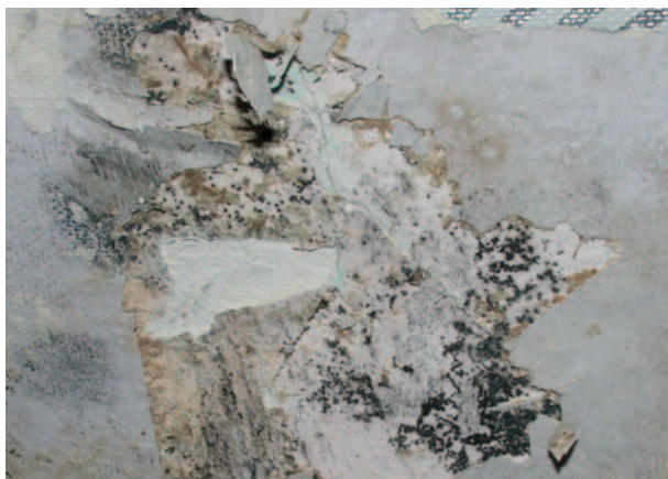
Schimmelpilzbefall hinter einer Tapete
