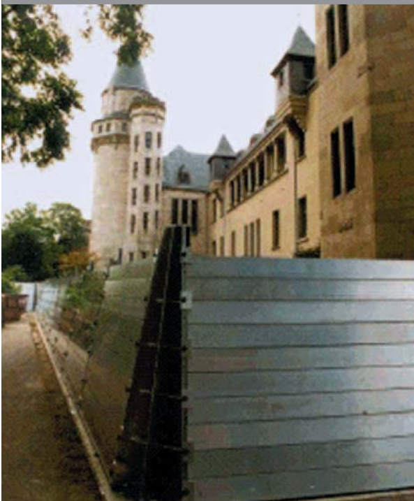
Mobiler Hochwasserschutz mit Dammbalken
