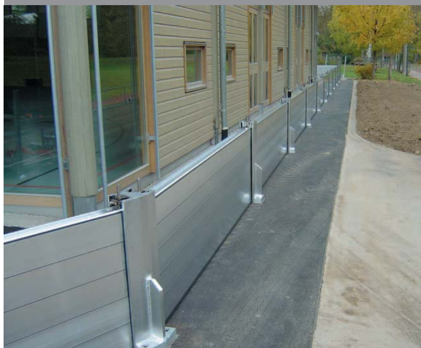
Umlaufender Hochwasserschutz mit mobilen Schutzelementen
