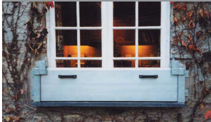
Hochwasserschutz an Fensteröffnungen
